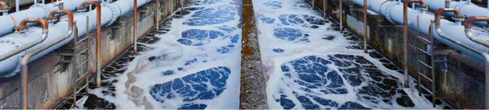
Kläranlage Seehausen Belebungsbecken
